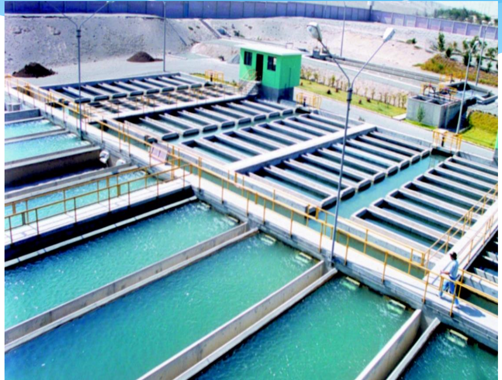
Planta de Agua Potable de Trujillo, ubicada en el sector Alto Moche.
