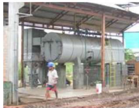
Figura 4: Nuevo caldero alimentado con aserrín
