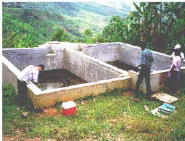
Filtro lento de arena en una zona rural
