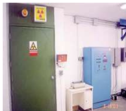
Figura 1: Sala de control de la Planta GB-127.
