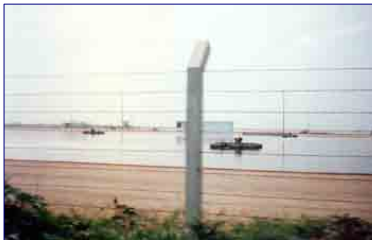
Figura 4.8 Pozas de oxidación de Covicorte del distrito de Trujillo.
