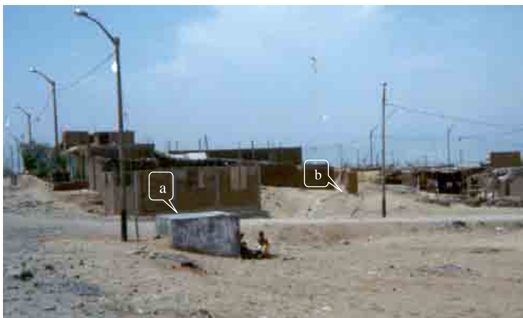
Figura 4.16. Viviendas en el sector Alto Trujillo del distrito El Porvenir; se muestra reservorio de agua (a) y letrina sanitaria (b) en condiciones deficientes.
