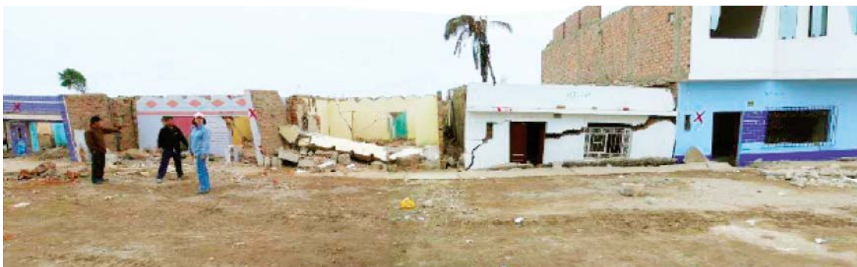
Gráfico N° 52. Viviendas colapsadas por licuación de suelos en Tambo de Mora
