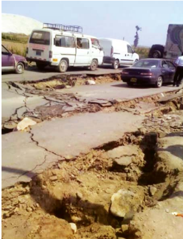
Gráfico N° 54. Roturas en terraplenes de carretera por licuación de suelos
