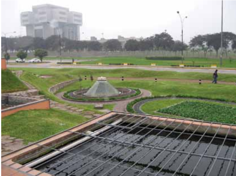
Figura N° 2.19: Vista panorámica de un biofiltro aerobio cubierto con paneles transparentes.
