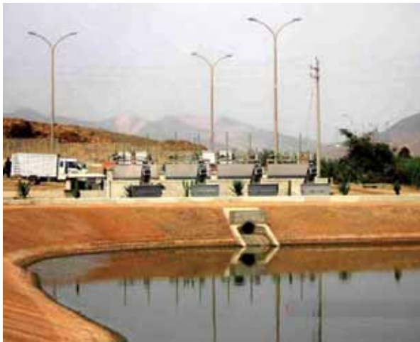
Figura N° 2.5: Vista de una planta de tratamiento que emplea lagunas de estabilización para el tratamiento de aguas residuales. El diseño hidráulico de ingreso y salida a las lagunas es importante para mejorar la eficiencia de los procesos de tratamiento en este tipo de unidades.
