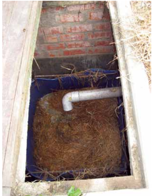
Figura N° 2.23: Cámaras de tratamiento preliminar del humedal artificial vertical, donde una de las cámaras de reposo está siendo aprovechada para hacer compost con la materia orgánica.
