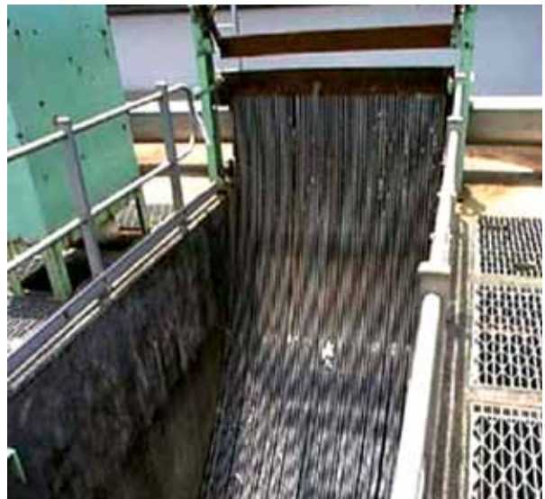
Figura N° 2.7: Las cámaras de rejas permiten la retención de residuos sólidos y material grueso previo al ingreso a las unidades de tratamiento primario.
