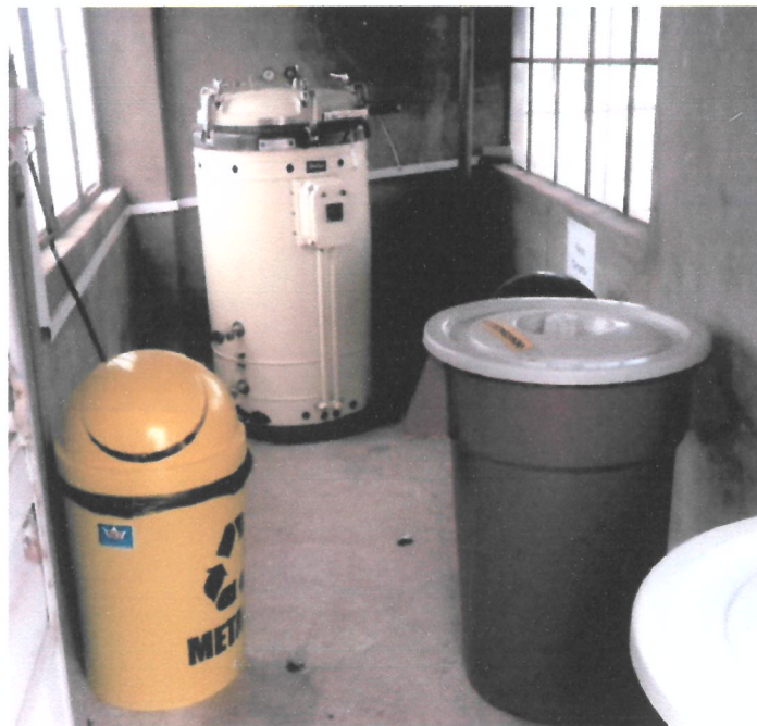
Fotografía 6. Autoclave de la Clínica Puno
