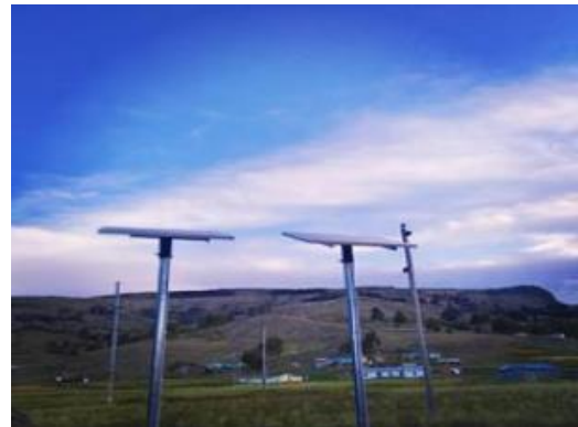
Figura 5. Paneles fotovoltaicos donados por la empresa Entelin.
