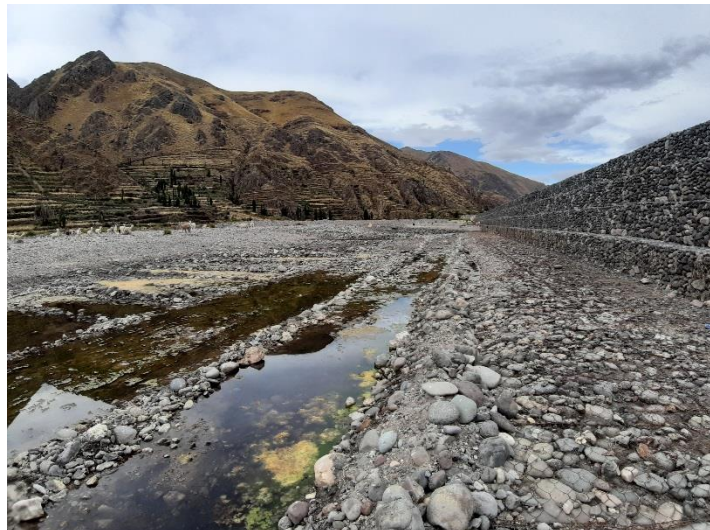
FOTO N° 03: Parte de las pozas de estabilización del poblado de Ichuña
