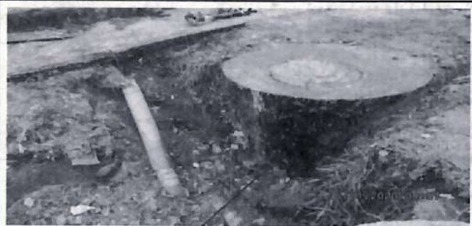
Foto 11: Buzón perforado en la parte inferior
