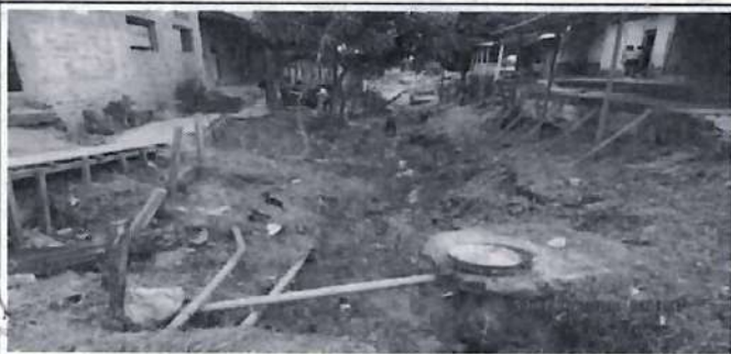
Foto 09: Discurrimiento de agua residual doméstico
