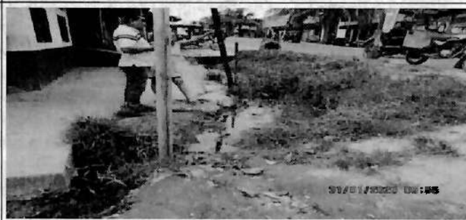
Foto 06: Cuneta convertido en desagüe.
