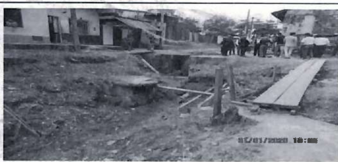
Foto 10: Discurrimiento de agua residual doméstico
