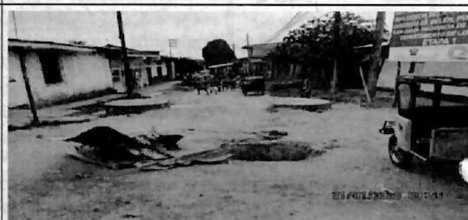
Foto 04: Vista panorámica del buzón sin tapa
