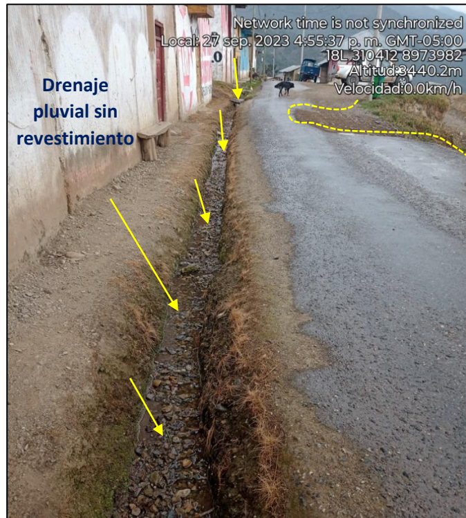
Figura 12 Vista del canal de drenaje pluvial sin revestimiento y la cabecera o corona del deslizamiento
