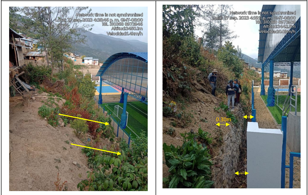
Se evidencia una alta pendiente desde la vivienda de la señora Ricardina hacia el polideportivo y se evidencio que las plantas y material cedieron hacia la parte baja del talud.
