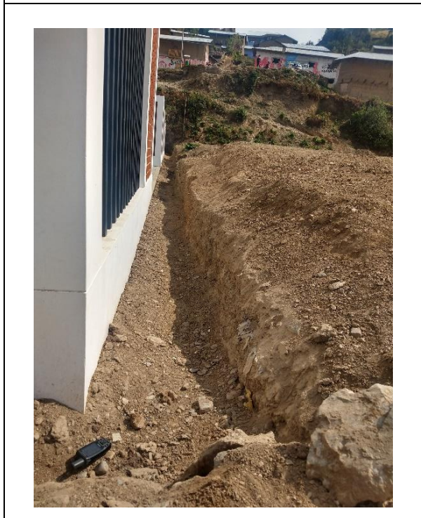
Parte frontal de polideportivo: Ancho de espacio de polideportivo de 1.00 m y una profundidad de 1.10 m el cual no tiene donde desfogar en caso allá acumulación de aguas producto de las precipitaciones
