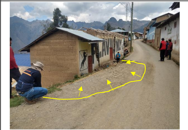
Tramo de la plataforma de la carretera afirmada con un ancho que cedió 2.0 m, largo de 14.7 m, hundimiento de 0.62 m
