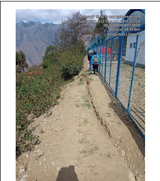
Parte lateral de polideportivo: Presencia de material excedente.
