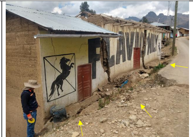
Vista frontal de la vivienda de la Sra .Iliada y afectación de vereda y carretera
