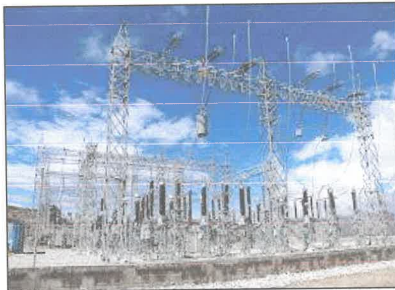
Grafico N°: 7 Subestación Eléctrica Montalvo
