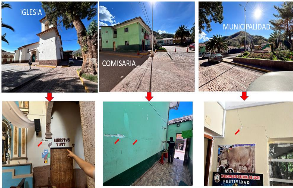
Figura 10: b) Daños en iglesia, comisaría y municipalidad de Lucre construidas con material de adobe y estucos de yeso debido a los sacudimientos del suelo producidos por el sismo de Lucre. Obsérvese las fisuras en paredes.
